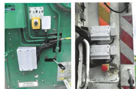
Rozdíl v instalacích čteček RFID čipů
